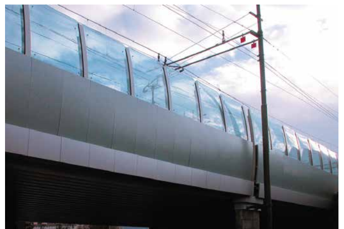
Noise barrier, Ponte Roma, Bolzano PLEXIGLAS® Soundstop GS CC FIP Industriale Spa, Selvazzano Dentro (Padova)
